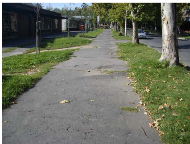
6. sz. fa A járda gyökerek által megemelt és megrepedezett aszfaltburkolata
