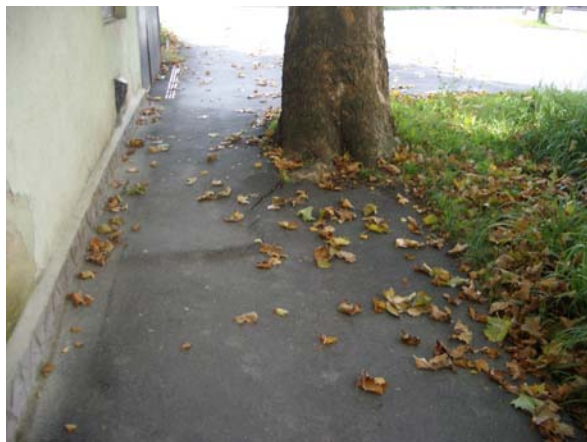
28. sz. fa a lakóház falától 150 cm-re van A gyökerek a járda burkolatát megemelték
